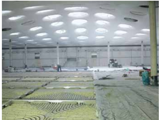
Bild 4 Hochwertiger Bodenaufbau mit Fußbodenheizung bei der Erweiterung des Städel Museums in Frankfurt/M.
