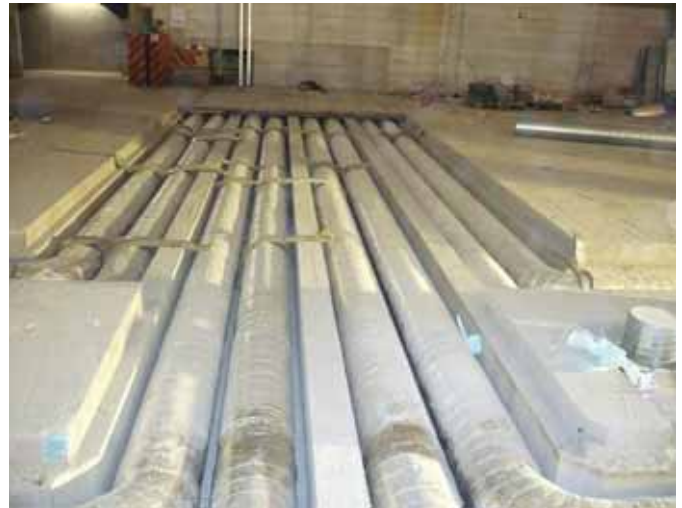
Bild 3 Erweiterung des Städel Museums in Frankfurt/M.: technische Anlage in der Bodenplatte integriert
